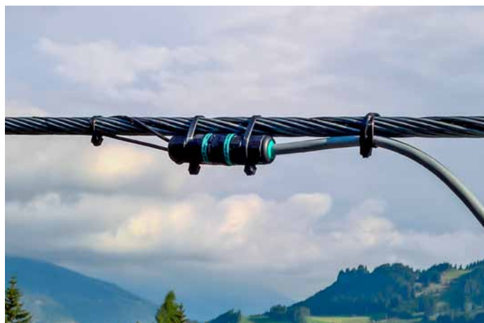
Connection BRUtelecom Data / Anschluss BRUtelecom Data
